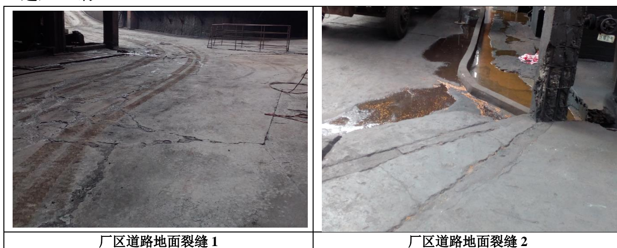
图 5-1 地面裂缝隐患
