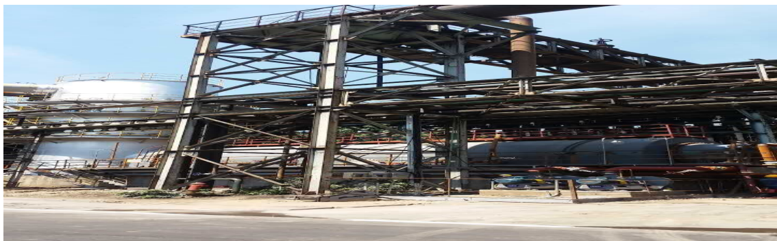
项目完工后的洗涤塔和焚烧炉
